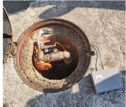
ISURLOG registrando presión de servicio en una red de distribución de agua potable
